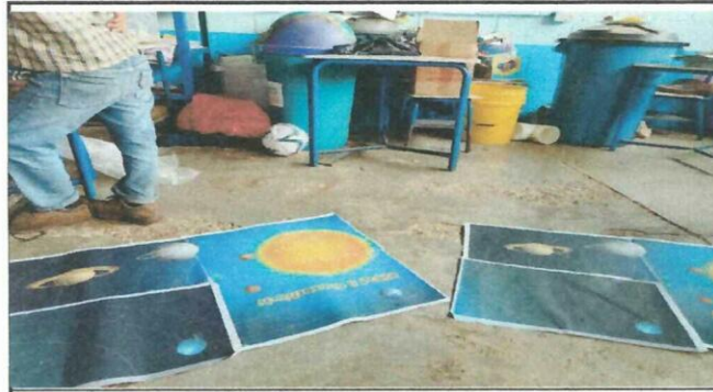
Foto 4. Se muestra el deterioro del piso hecho de concreto, el cual compromete la seguridad de los niños y crea un entorno inadecuado para el aprendizaje.
