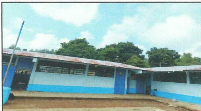
Foto 2. La cubierta del modulo de lamina del modulo dos se encuentra en mal estado, existen filtraciones de agua hacia el interior de varias aulas.
