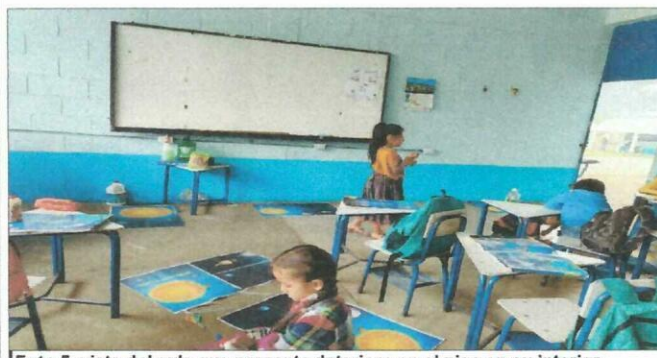
Foto 5. vista del aula que presenta deterioro en el piso en su interior
