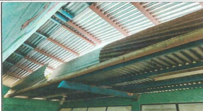
Foto 1. la cubierta de lamina del modulo 1, esta a punto de colapsar, en epoca lluviosa se filtra el agua y el espacio se encuentra inundado constantemente
